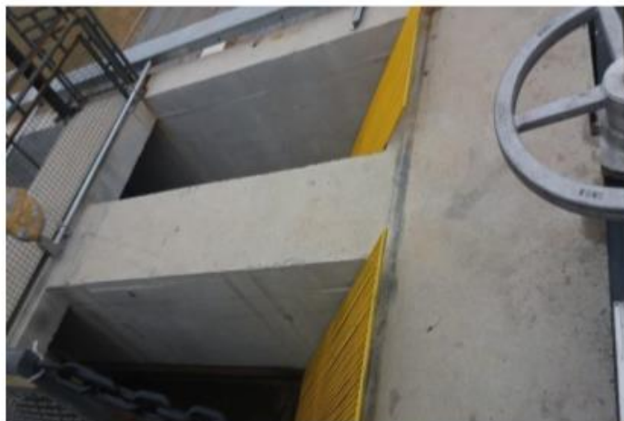
Foto 3 – Grade de tratamento preliminar
