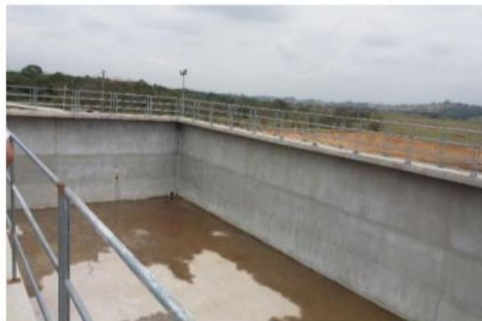
Foto 4 – Tanque Aeróbio de Lodo
