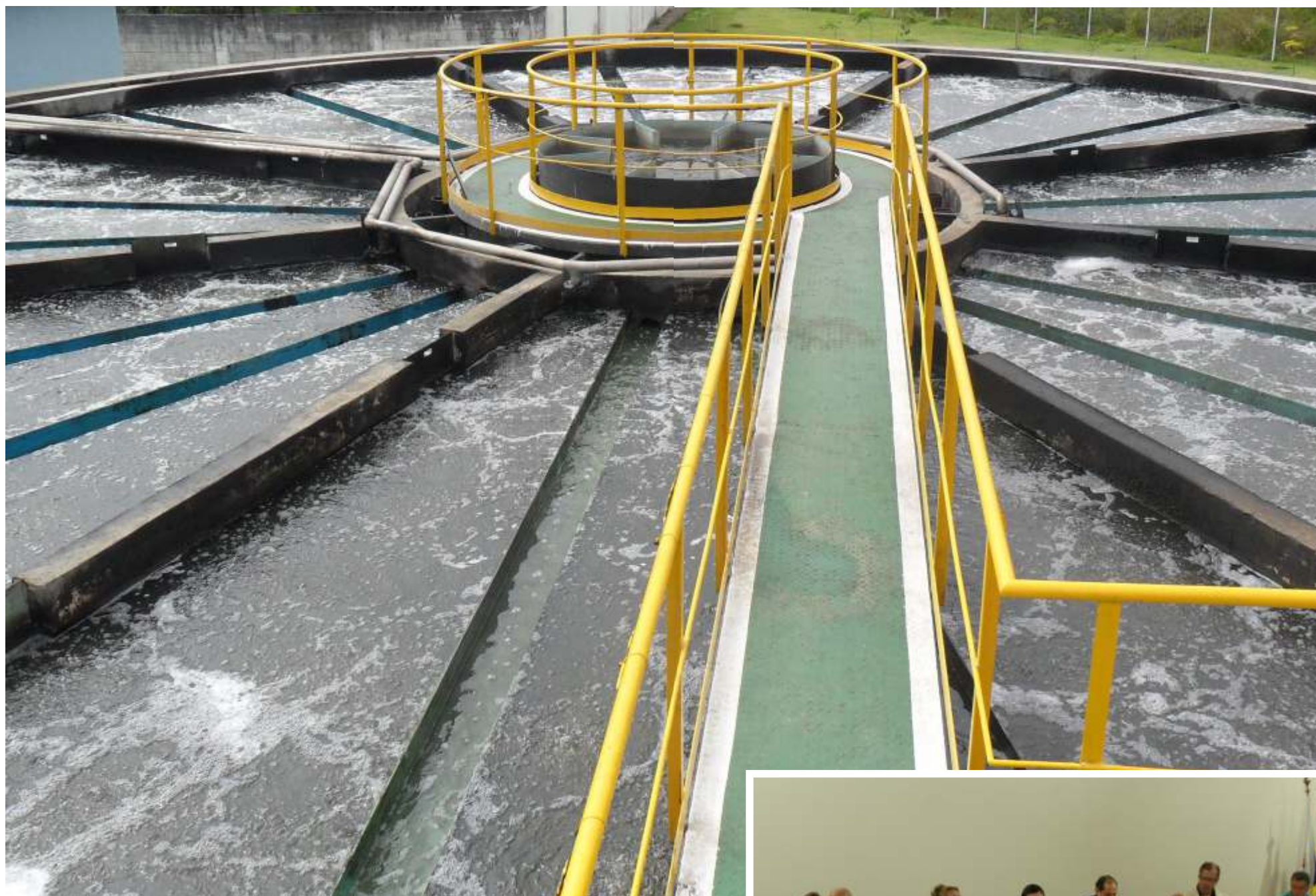
Estação de Tratamento de Esgoto localizada na Região Hidrográfica do Médio Paraíba do Sul
