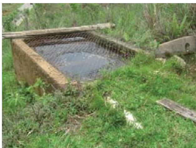
Figura 21 – Captação do Córrego Beltino de Souza
