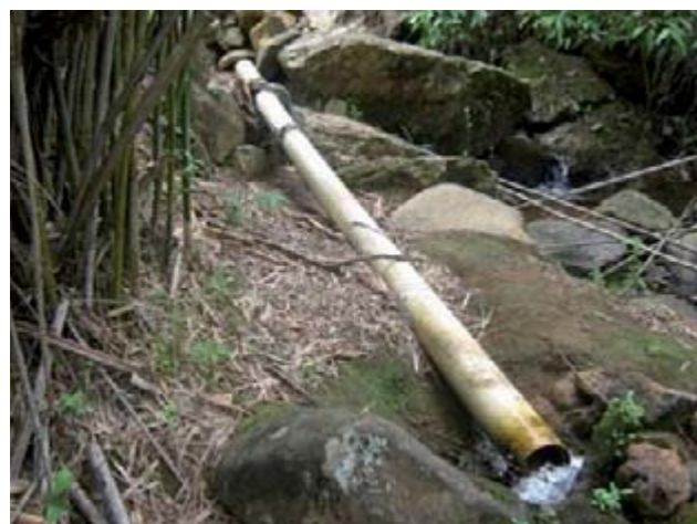
Figura 18 – Córrego Beltino de Souza – tubulação de adução.
