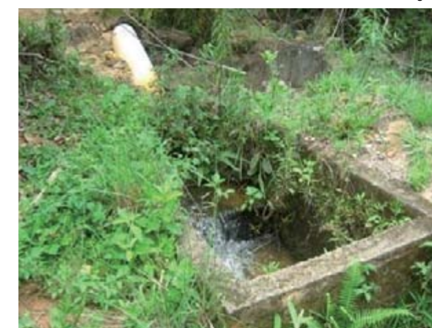
Figura 17 – Córrego Beltino de Souza – caixa de captação.
