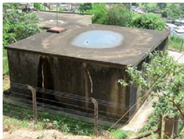
Figura 49 – Reservatório da ETA 1.
