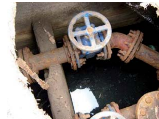
Figura 58 – Estação Elevatória – vista 4.
