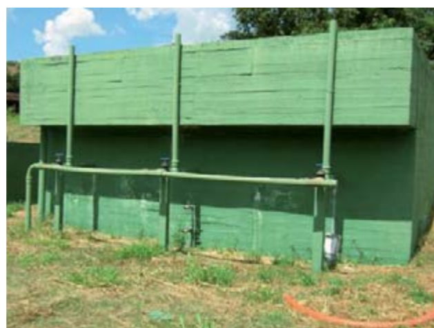
Figura 62 – Reator Anaeróbio de fluxo ascendente
