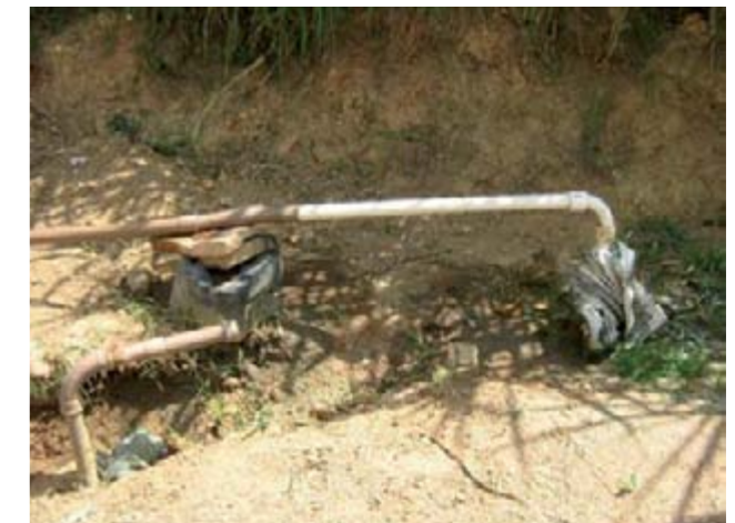
Figura 32 – Vista do poço tubular profundo
