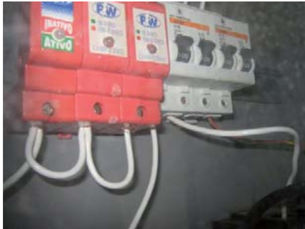
Figura 27 – Instalações elétricas da captação – Córrego da Prata.
