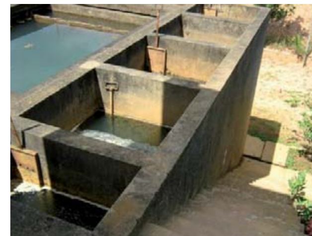
Figura 38 – Vista das unidades de tratamento – ETA 1.
