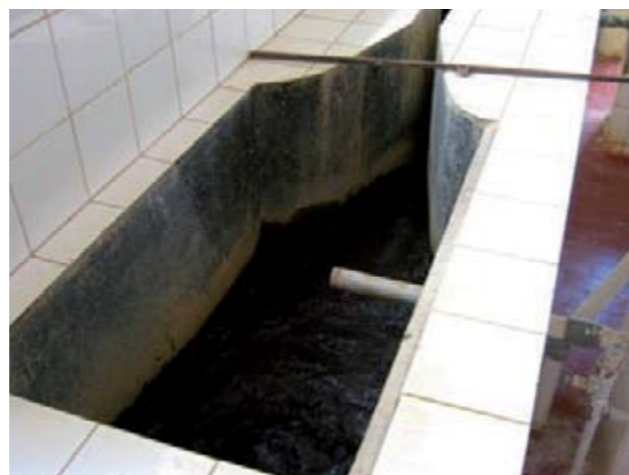
Figura 36 – Chegada da água bruta na ETA 1.
