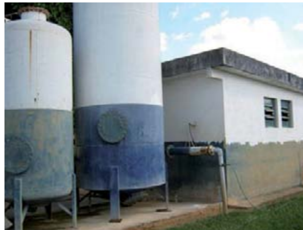
Figura 44 – Vista dos Filtros e Casa de Química da ETA 2.
