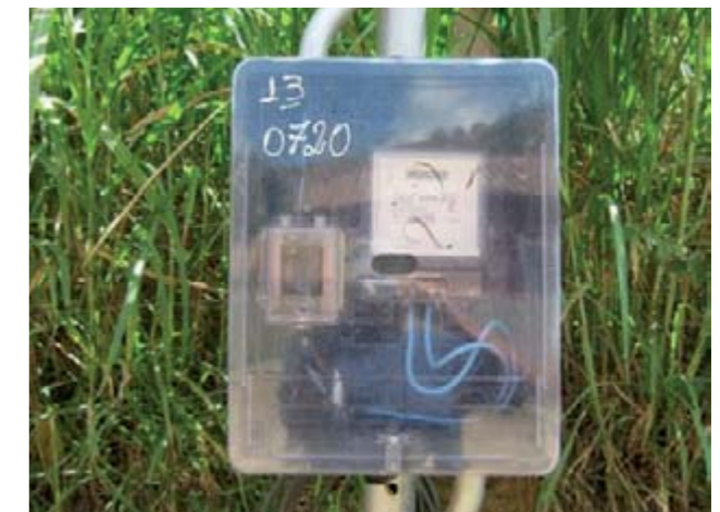
Figura 33 – Instalações elétricas do poço tubular profundo.
