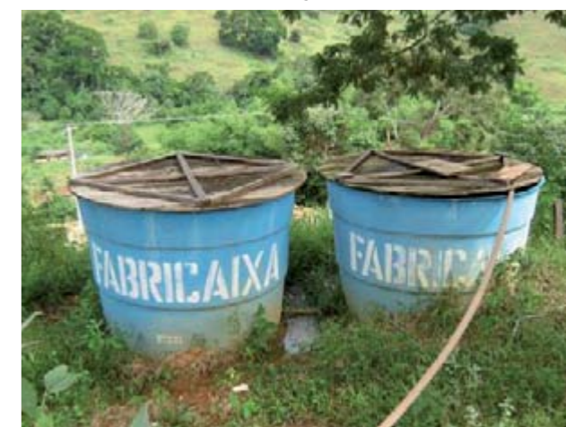
Figura 54 – Reservatório poço tubular profundo - vista 2
