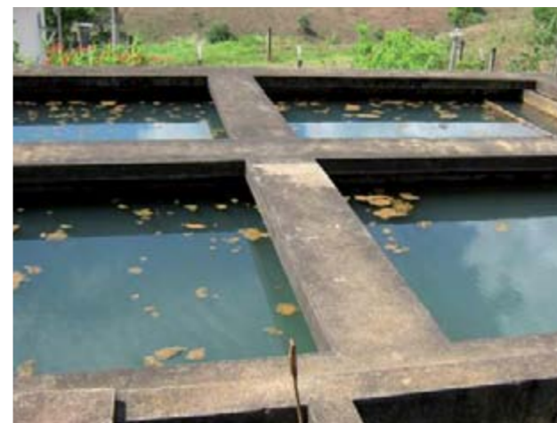
Figura 37 – Vista das unidades de tratamento – ETA 1.
