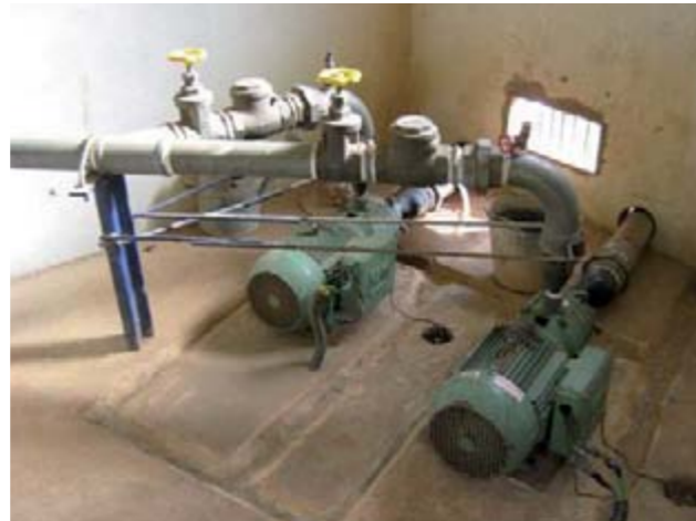
Figura 28 – Sistema de captação de água - Córrego da Prata
