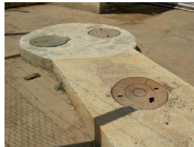
Figura 55 – Estação Elevatória – vista 1.
