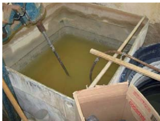
Figura 47 – Tanque de preparação de produtos químicos – ETA 2
