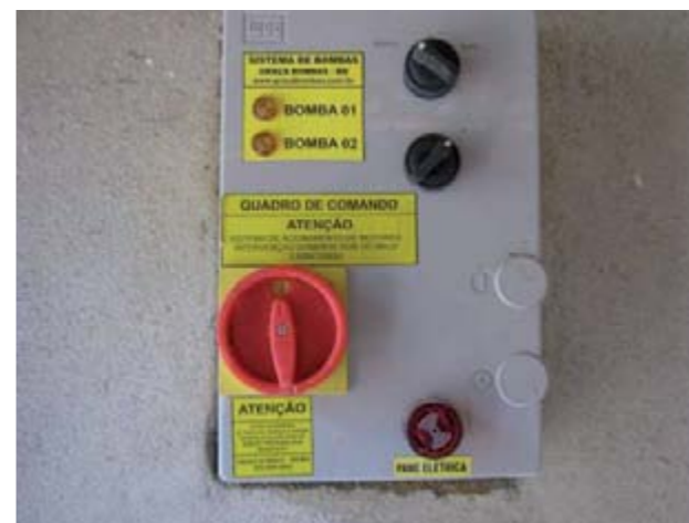
Figura 57 – Estação Elevatória – vista 3.
