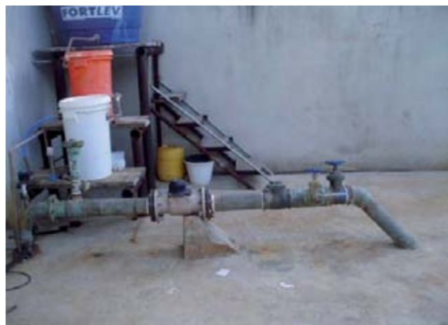
Figura 25 – Sistema de tratamento.
