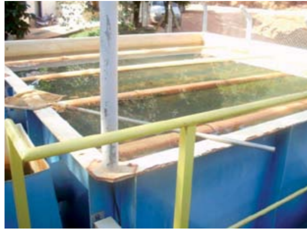
Figura 20 – Unidades de tratamento.
