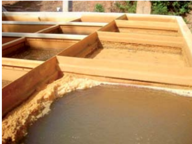
Figura 19 – Vista dos floculadores.
