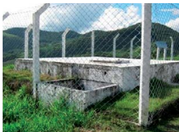
Figura 36 – Reservatório bairro Santo Antônio.
