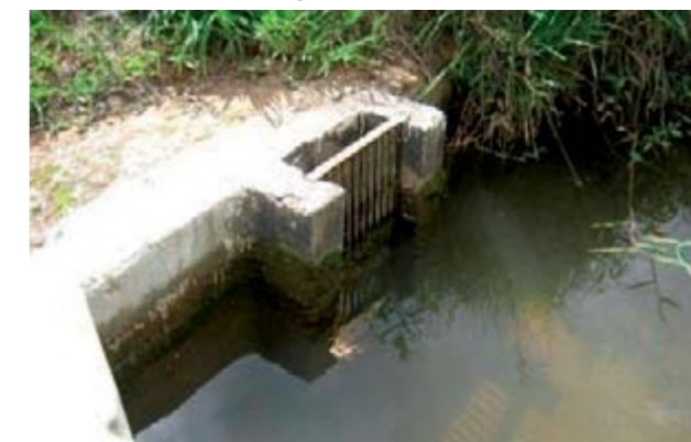
Figura 24 – Captação córrego das Flores - vista 4
