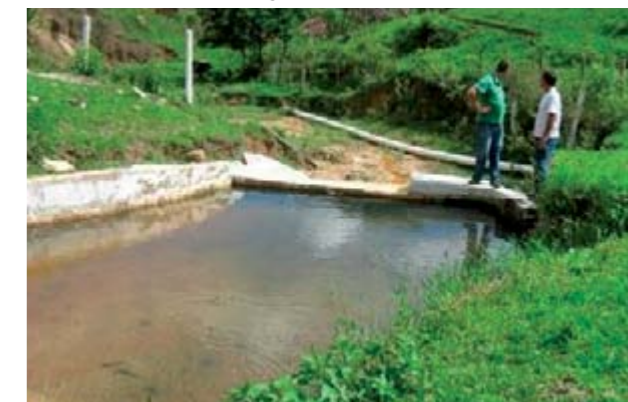
Figura 22 – Captação córrego das Flores - vista 2
