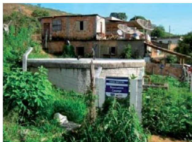
Figura 34 – Reservatório bairro Caxangá.
