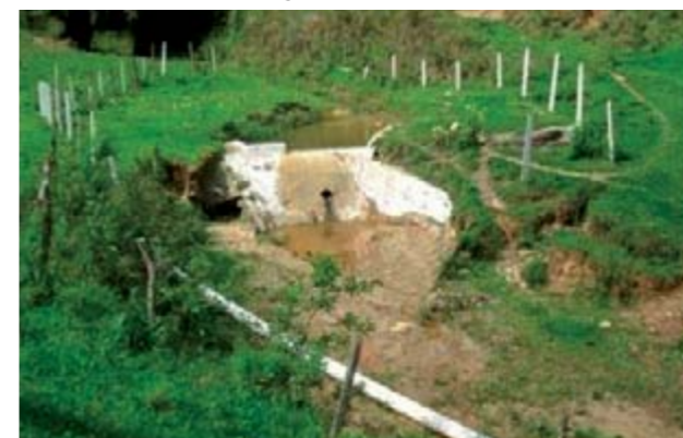
Figura 23 – Captação córrego das Flores - vista 3
