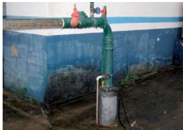
Figura 27 – Poço tubular profundo - vista 3
