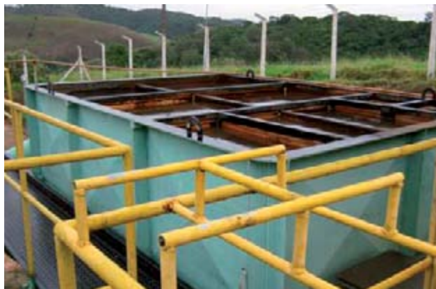
Figura 33 – Unidades de tratamento.
