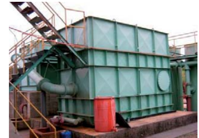
Figura 30 – Unidades de tratamento.
