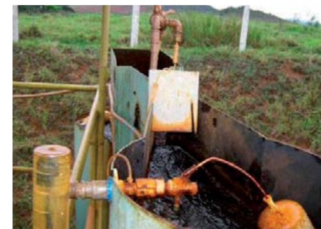
Figura 31 – Unidades de tratamento.
