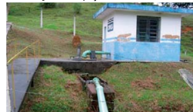
Figura 23 – Captação Bela Itália - vista 1.
