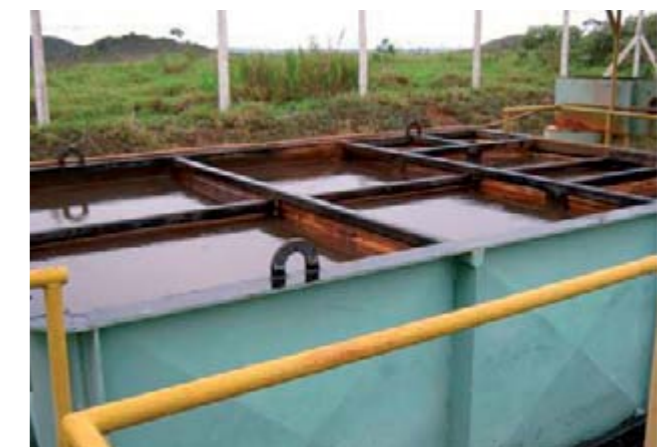
Figura 32 – Unidades de tratamento.
