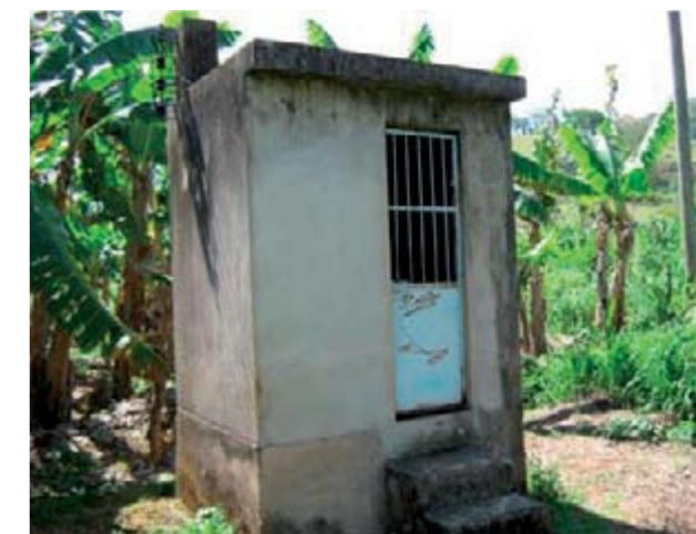
Figura 26 – Abrigo das instalações elétricas.
