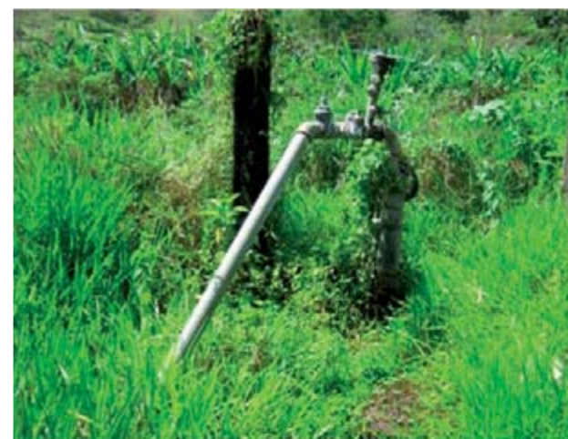
Figura 25 – Vista do poço tubular profundo.
