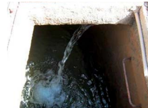
Figura 30 – Entrada de água no reservatório.
