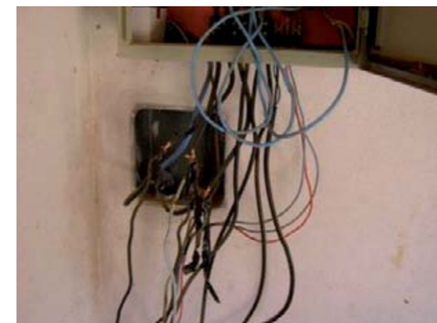
Figura 29 – Instalações elétricas Poços 1 e 2
