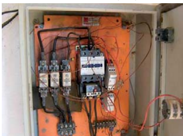
Figura 32 – Quadro de força Poço 3.
