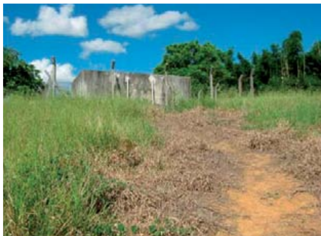
Figura 44 – Reservatório Poço 4 vista 1.
