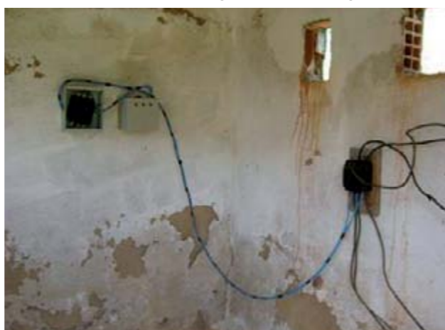
Figura 33 – Instalações elétricas Poço 3
