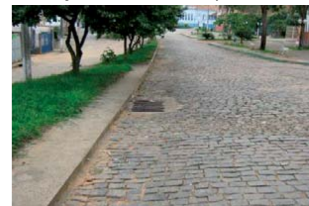
Figura 52 – Inexistência de sarjetas vista 2
