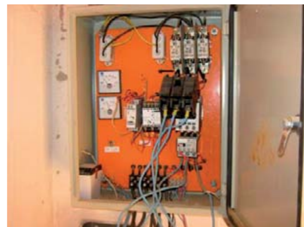
Figura 28 – Quadro de força Poços 1 e 2.
