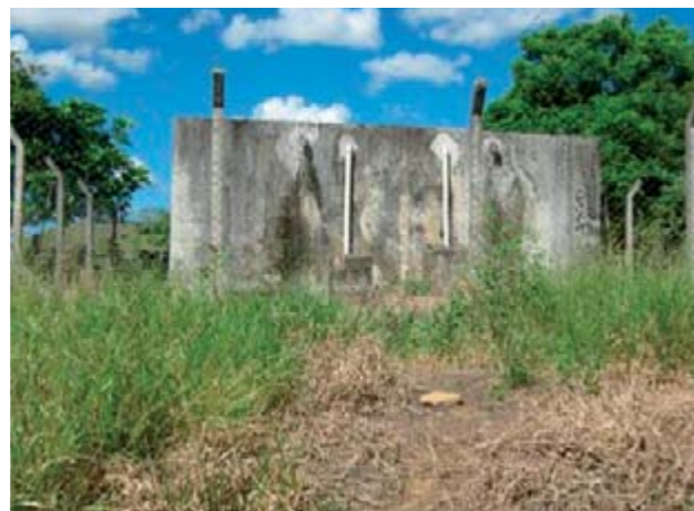
Figura 45 – Reservatório Poço 4 vista 2.
