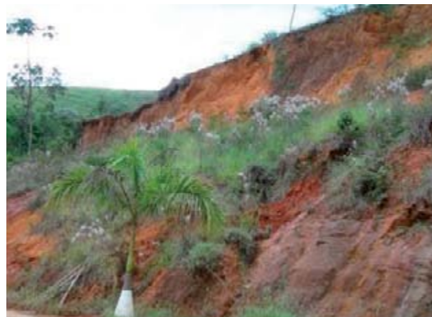
Figura 49 – Talude instável vista 2
