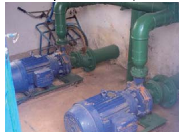
Figura 31 – Bomba de recalque
