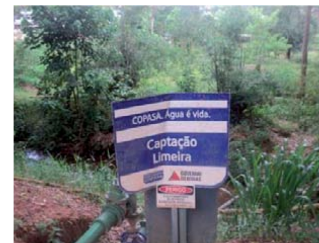
Figura 24 – Placa de identificação da Captação Limeira.
