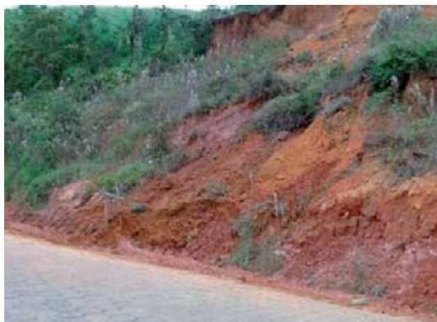
Figura 48 – Talude instável vista 1
