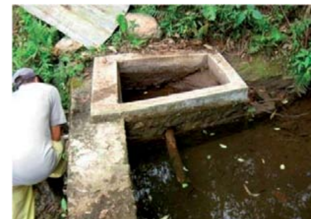
Figura 30 – Caixa de captação
