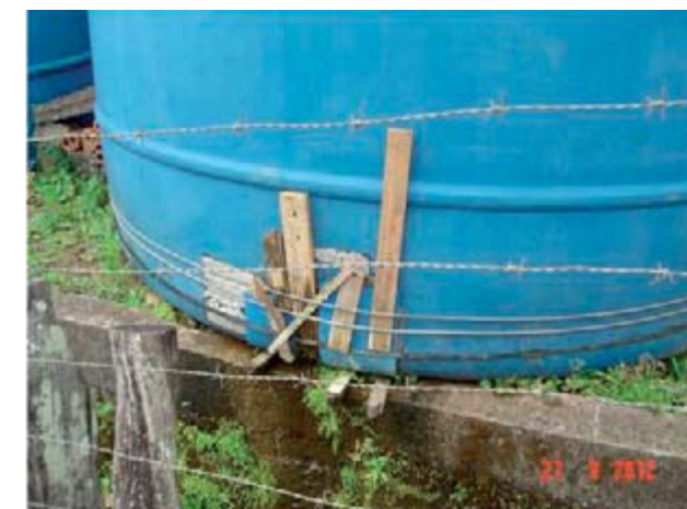
Figura 38 – Vazamento verificado no reservatório.
