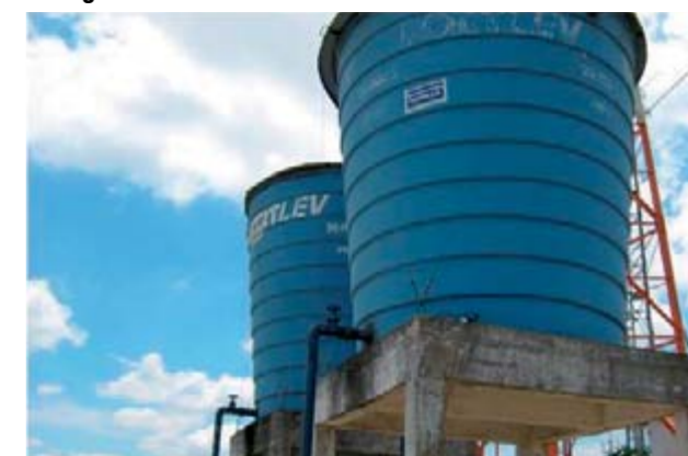
Figura 40 – Detalhe dos reservatórios de 20 m³ cada.
