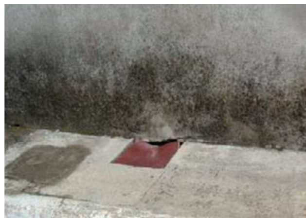
Figura 26 – Domicílio com pena d'água instalada.
