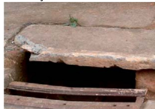
Figura 53 – Bocas de lobo danificadas.
