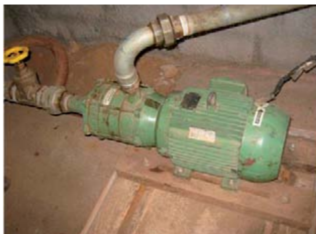
Figura 34 – Sistema de bombeamento.
