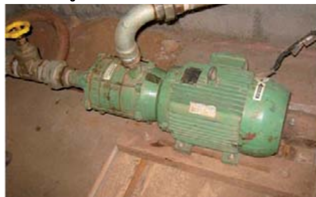
Figura 34 – Sistema de bombeamento.
