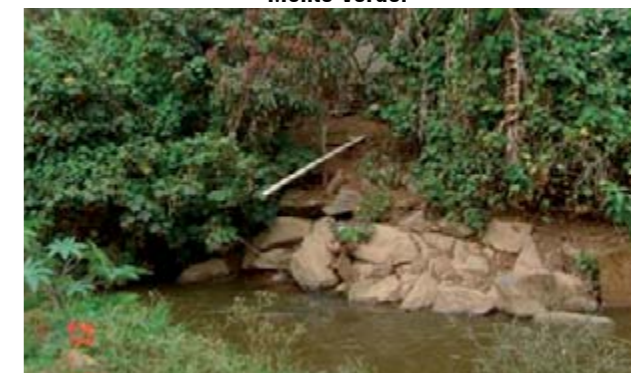
Figura 46 – Tubulação de lançamento de esgoto no rio Monte Verde.
