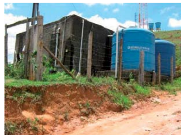
Figura 37 – Centro de reservação 1.
