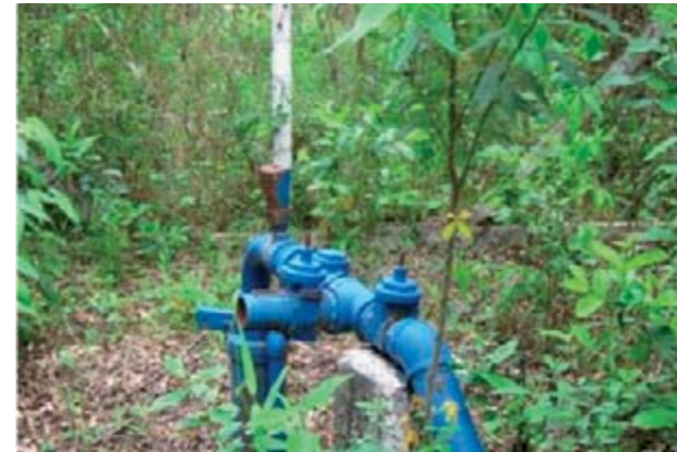
Figura 35 – Poço tubular profundo.
