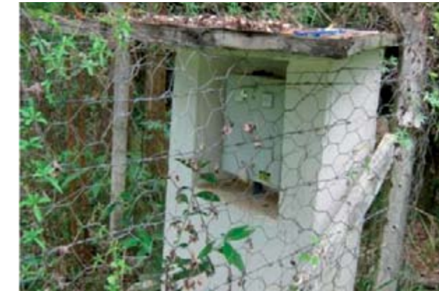
Figura 36 – Cerca de proteção.
