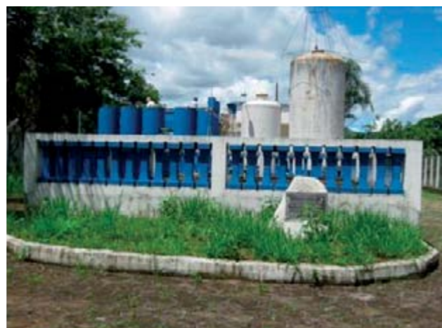
Figura 23 – Instalações da ETA.
