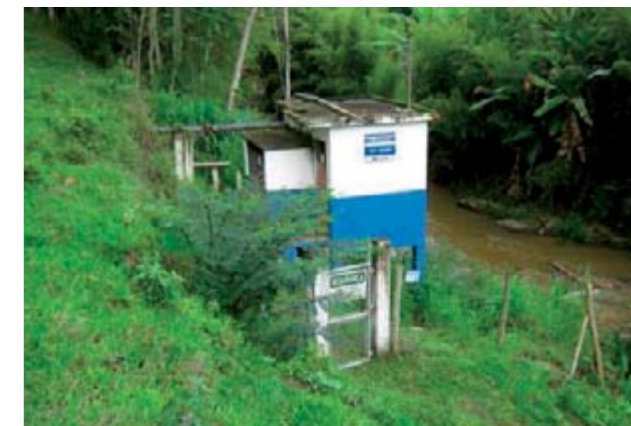
Figura 17 – Rio Pomba – estação elevatória vista 2.
