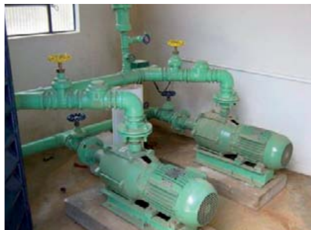
Figura 30 – EEAT vista das bombas.
