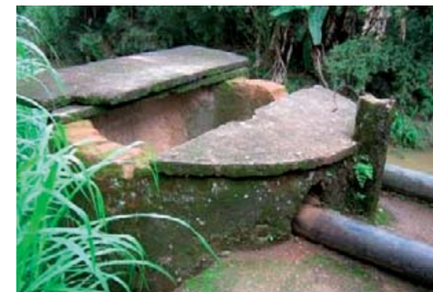
Figura 21 – Poço de captação
