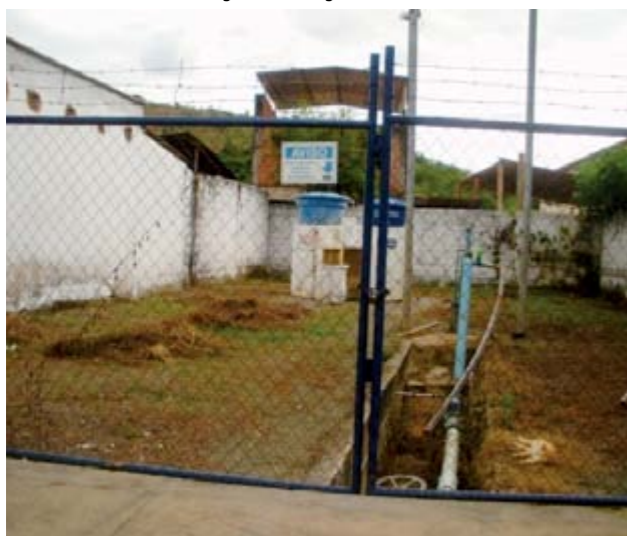
Figura 26 – Captação do poço tubular profundo vista 1
