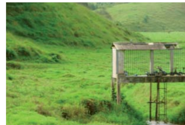
Figura 22 – Captação córrego da Fumaça vista 1
