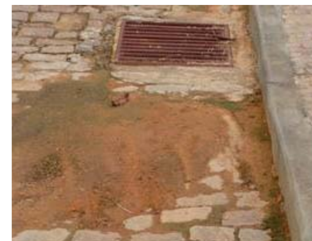
Figura 40 – Carreamento de sedimentos.
