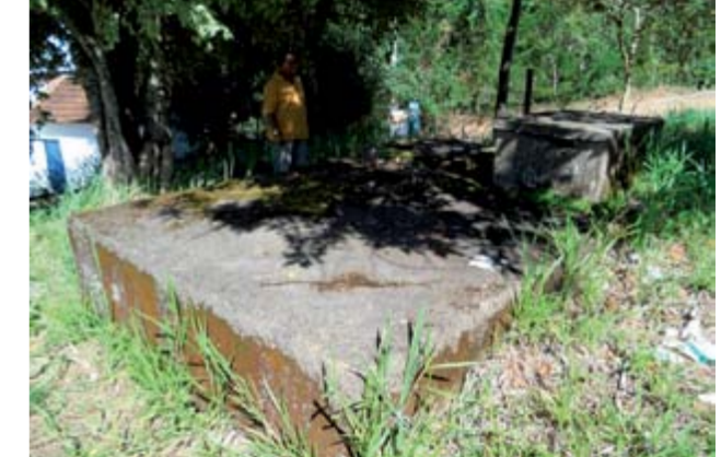
Figura 65 – Reservatório 12 m³ Sossego vista 2.
