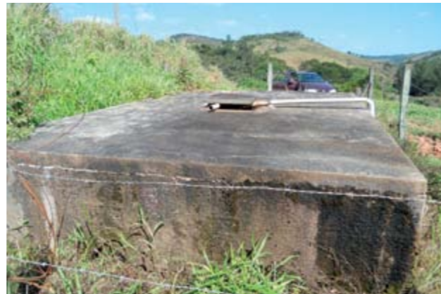
Figura 63 – Reservatório 30 m³ Sossego vista 2.
