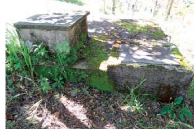
Figura 64 – Reservatório 12 m³ Sossego vista 1.
