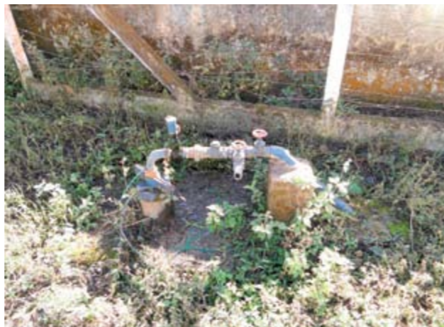
Figura 55 – Poço Rua Milton Monteiro da Silva vista 2.
