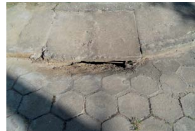
Figura 80 – Boca-de-lobo Flores, Migliano e Serraria vista 1
