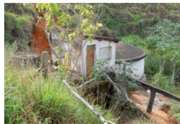
Figura 32 – Sistema de decantação e reservação vista 1.
