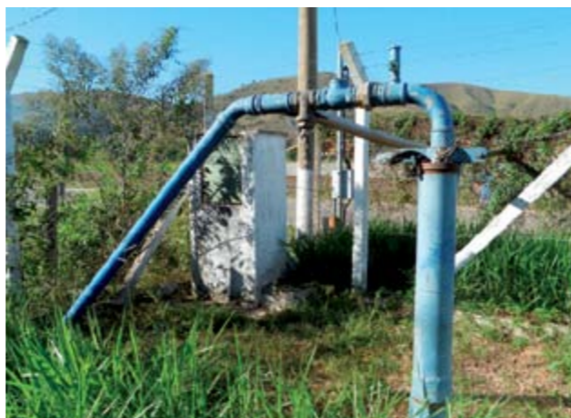
Figura 47 – Poço tubular profundo situado às margens da estrada Serraria-Souza Aguiar vista 2.
