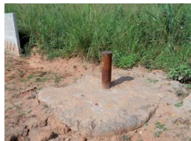
Figura 44 – Poço tubular inoperante vista 1
