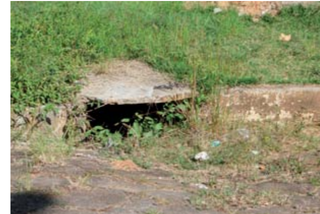
Figura 78 – Boca-de-lobo Centro vista 1
