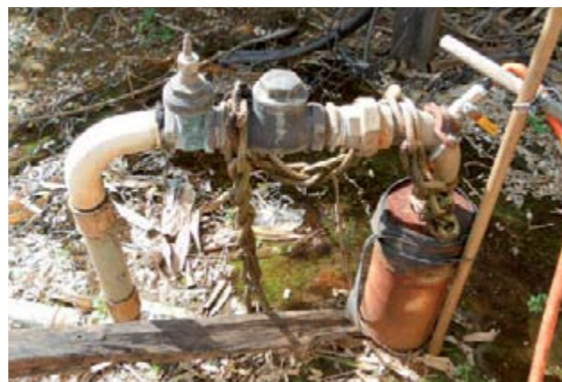
Figura 31 – Poço tubular profundo Fazenda Santana vista 1.
