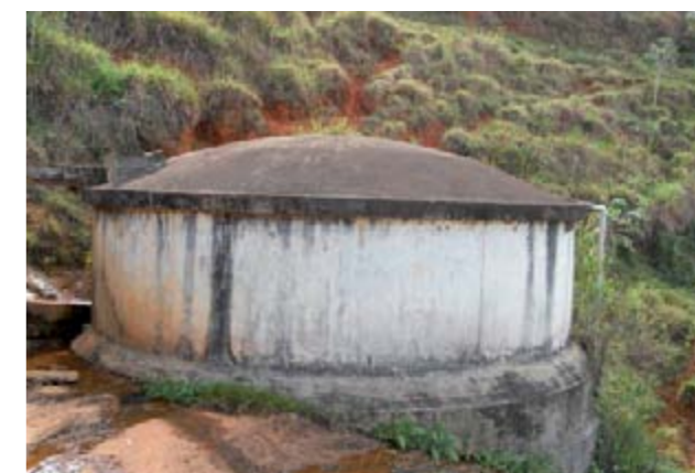
Figura 33 – Sistema de decantação e reservação vista 2.
