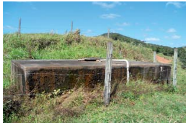
Figura 62 – Reservatório 30 m³ Sossego vista 1.
