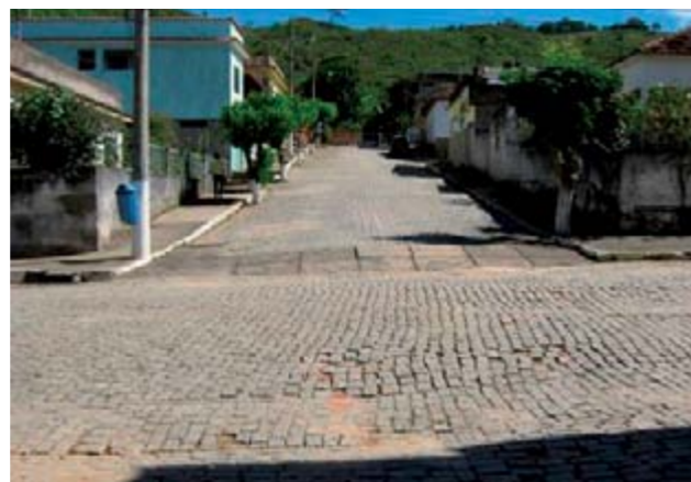
Figura 52 – Inexistência de sarjeta vista 2.
