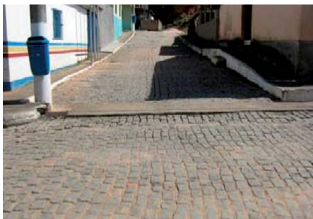
Figura 51 – Inexistência de sarjeta vista 1.
