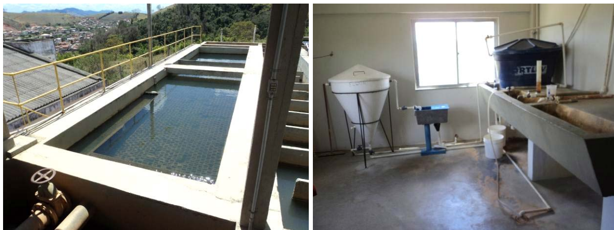
Figuras 4.1.3 a 4.1.6 – Estação de Tratamento de Água.
