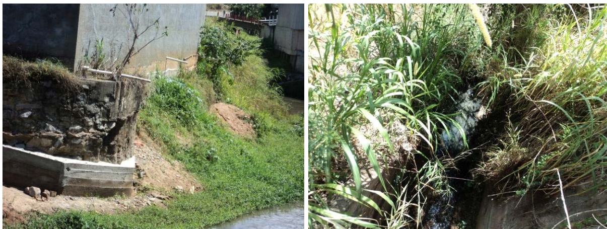
Figuras 4.2.1 e 4.2.2 – Lançamento de esgoto in natura nos corpos hídricos.
