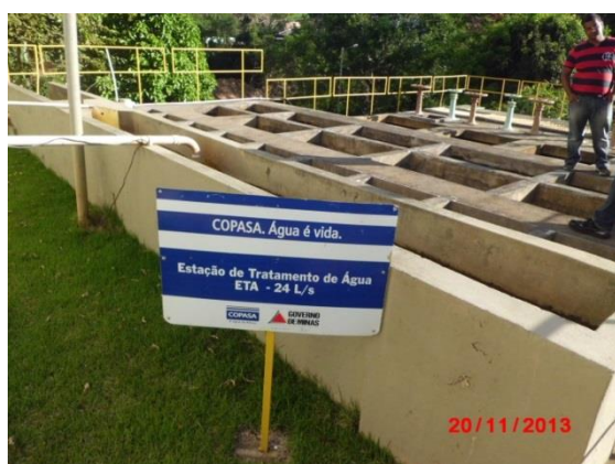
Figura 18: ETA Divino – calha parshall. Fonte: Conen
