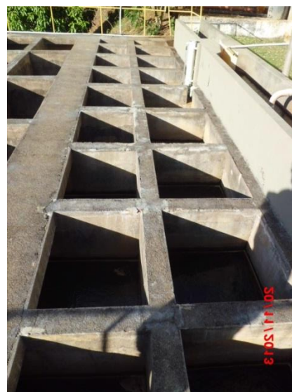
Figura 21: ETA – Flocculadores. Fonte: Conen
