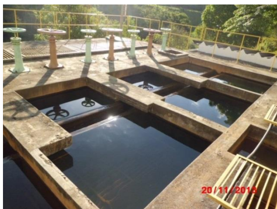
Figura 20: ETA – Decantadores. Fonte: Conen
