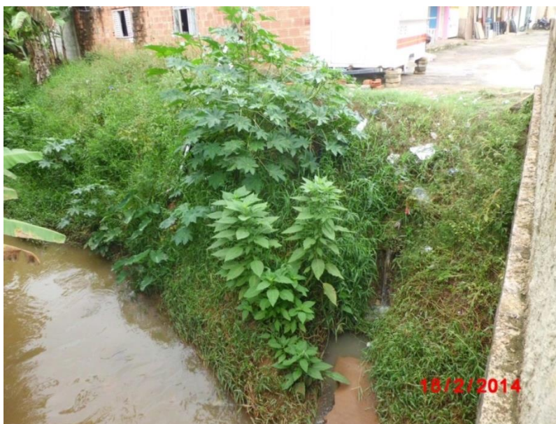
Figura 34: Lançamento de esgoto in natura na Sede Municipal Fonte: Conen
