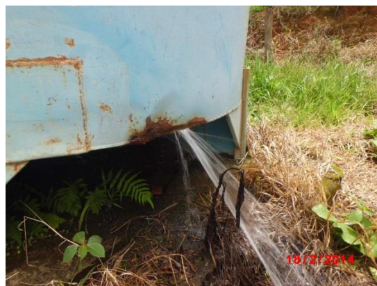
Figura 22: Vazamento em reservatório de Vista Alegre. Fonte: Conen
