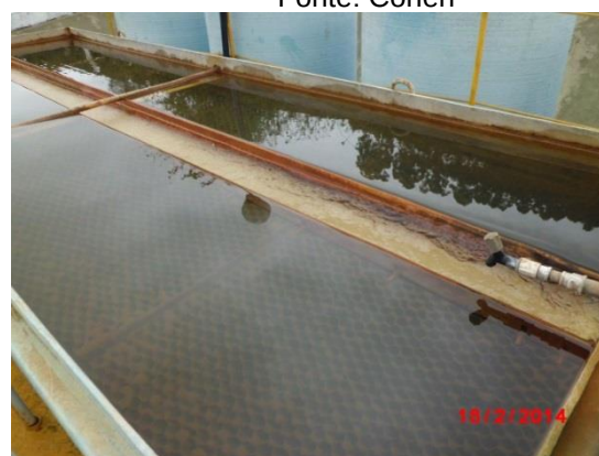
Figura 18: Decantadores. Fonte: Conen
