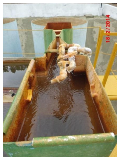
Figura 16: Calha Parshall .. Fonte: Conen
