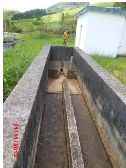
Figura 25: ETE – Caixa de areia e calha parshall . Fonte: Conen
