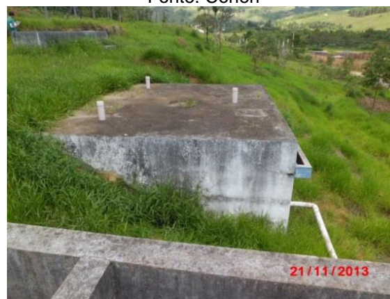
Figura 27: ETE - filtro biológico. Fonte: Conen
