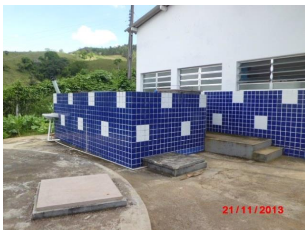
Figura 17: ETA – Tanque de contato. Fonte: Conen
