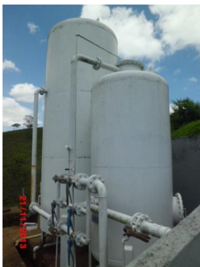
Figura 15: ETA Pedra Dourada. Fonte: Conen
