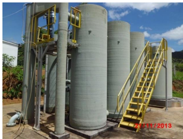
Figura 16: ETA Pedra Dourada. Fonte: Conen
