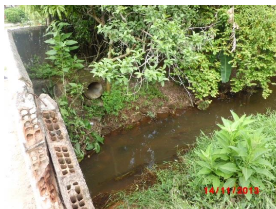
Figura 40: Lançamento de esgoto no Córrego da Jacuba – São João da Serra Fonte: Conen
