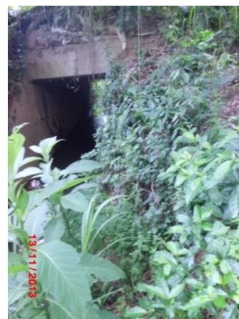
Figura 30: Lançamento de esgoto em corpo hídrico na região Fonte: Conen
