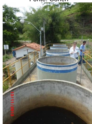
Figura 24: Filtros da ETA Fonte: Conen
