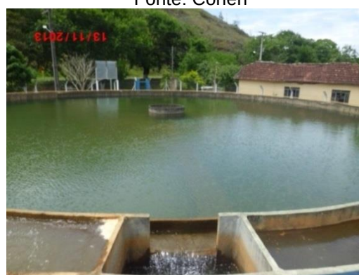
Figura 22: Decantador e floculador da ETA Fonte: Conen
