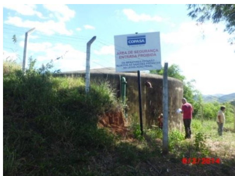
Figura 25: Reservatório geral Fonte: Conen
