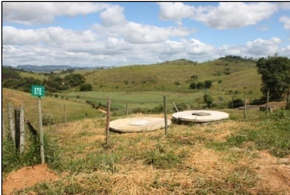
Figura 33 – Sistema de tratamento do chorume
