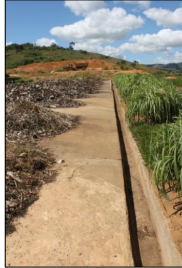
Figura 32 – Vista das canaletas para drenagem de líquidos
