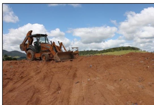
Figura 37 – Máquinas utilizadas no Aterro Controlado
