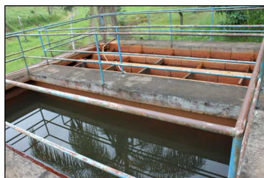
Figura 11 – Estação de Tratamento de Água (ETA)
