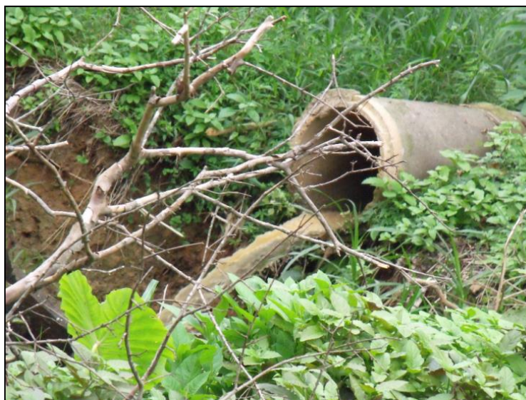
Figura 12 - Lançamento de efluente in natura no rio
