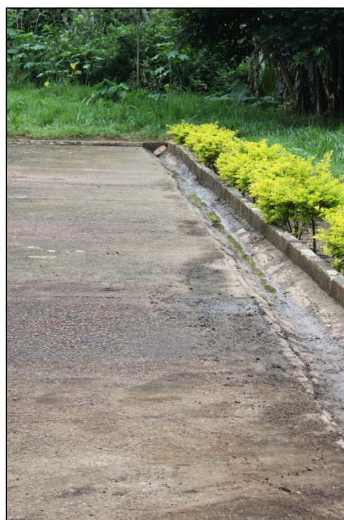
Figura 38 – Vista das canaletas para drenagem de líquidos
