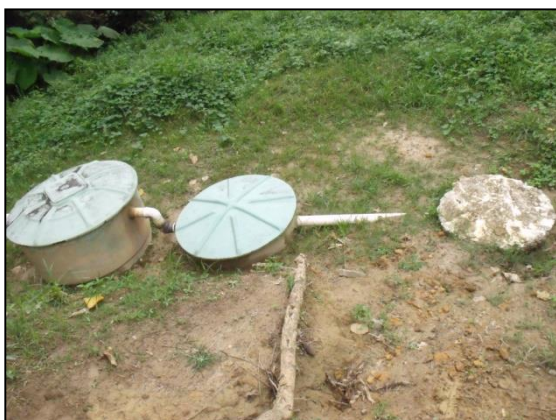
Figura 37 – Sistema de tratamento de efluente
