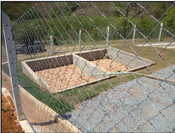
Figura 26 – Vista dos leitos de secagem
