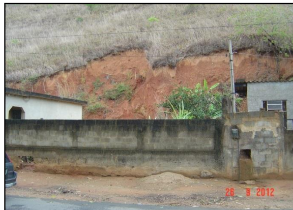
Figura 41 – Erosão de talude
