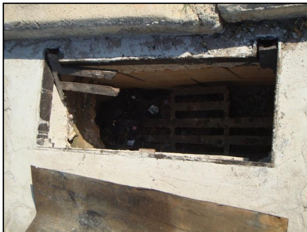
Figura 34 – Boca de lobo apresenta grade danificada
