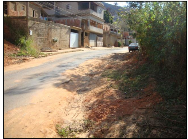
Figura 33 – Erosão e pavimentação comprometida pela falta de drenagem
