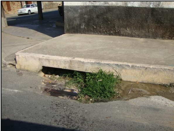
Figura 36 – Boca de lobo obstruída
