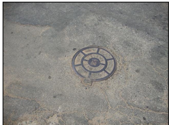
Figura 23 – Poço de visita – localizado no bairro Monte Serrat
