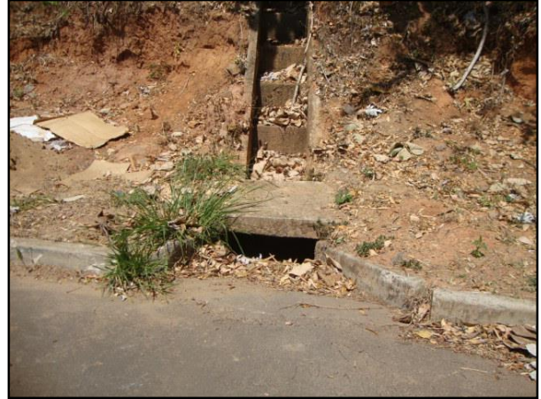
Figura 37 – Sistema de drenagem necessitando de limpeza
