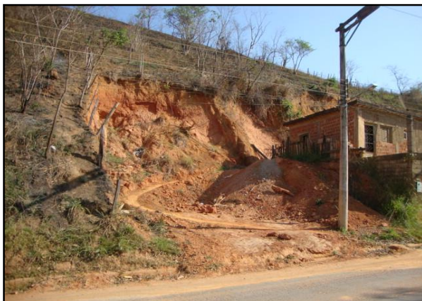
Figura 40 – Erosão de talude
