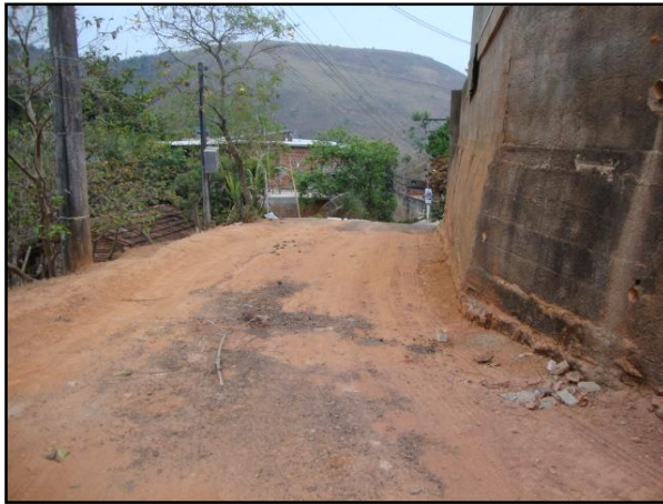
Figura 32 – Rua com carreamento de solo pela falta de drenagem
