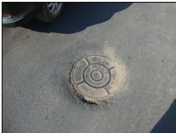
Figura 22 – Poço de visita – localizado no bairro Fonseca Almeida
