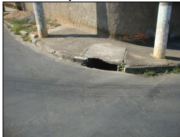
Figura 35 – Boca de lobo danificada e sarjeta obstruída
