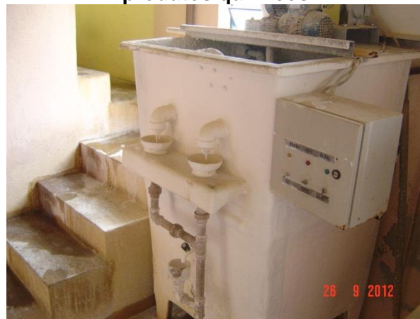
Figura 13 – Sistema de dosagem de produtos químicos
