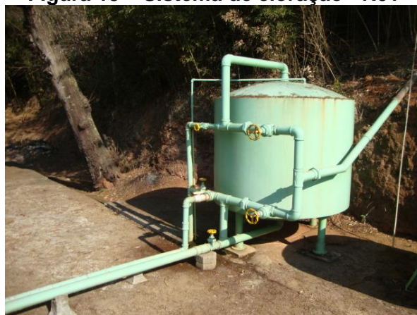
Figura 15 – Sistema de cloração - R01
