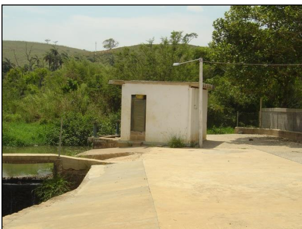
Figura 9 – Estação elevatória de água bruta
