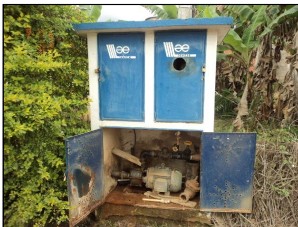
Figura 27 – Sistema de bombeamento
