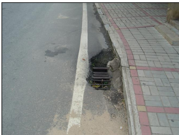
Figura 37 – Boca de lobo em péssimo estado de conservação 1
