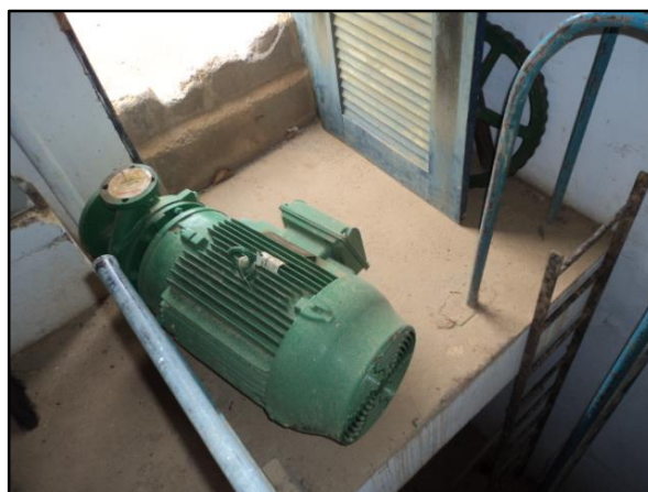
Figura 12 – Estação elevatória de água bruta - vista 2
