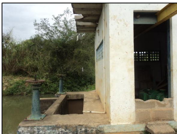
Figura 11 – Estação elevatória de água bruta - vista 1
