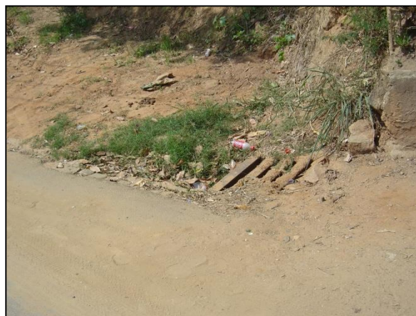
Figura 38 – Caixa de captação obstruída com terra e lixo
