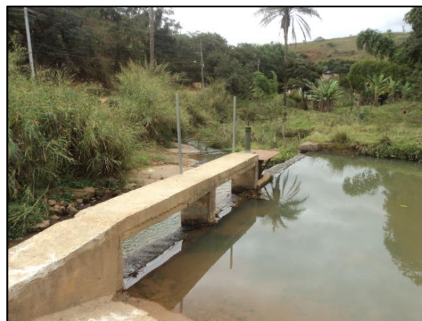
Figura 8 – Barragem de nível vista 2
