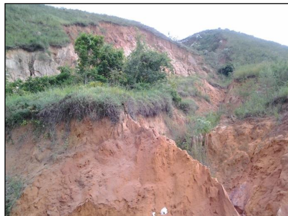
Figura 35 – Erosão de talude (vista 2)
