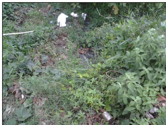
Figura 31 – Lançamento de esgoto
