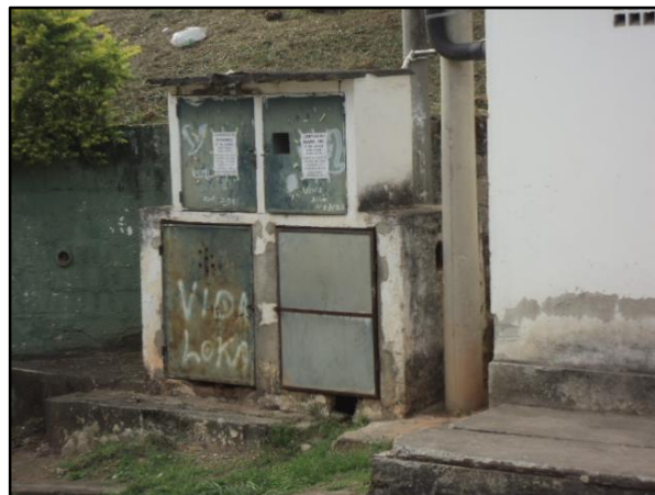
Figura 13 – Estação Elevatória de Água Tratada (Vista 2)
