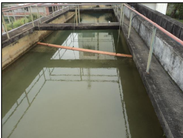
Figura 16 – Decantador da ETA Pinheiral
