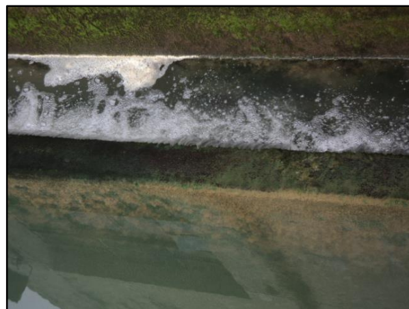
Figura 17 – Canaletas laterais no decantador da ETA Pinheiral
