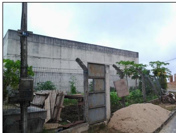
Figura 24 – Reservatório Morro do Cruzeiro
