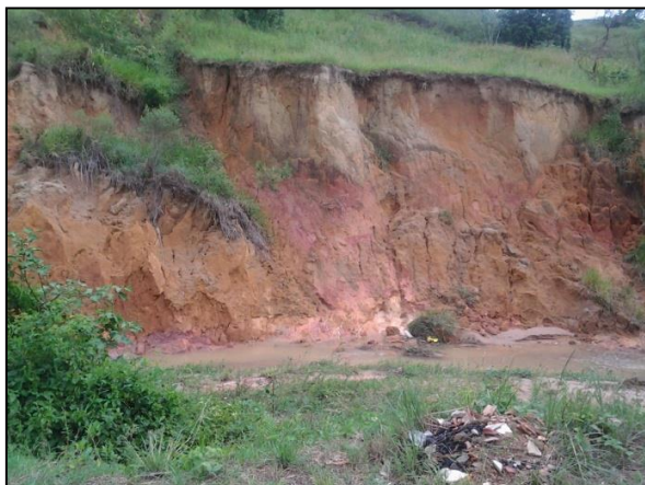
Figura 34 – Erosão de talude (vista 1)
