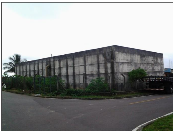
Figura 23 – Reservatório Morro do Cruzeiro
