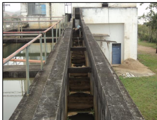
Figura 15 – ETA Pinheiral (Vista 2)
