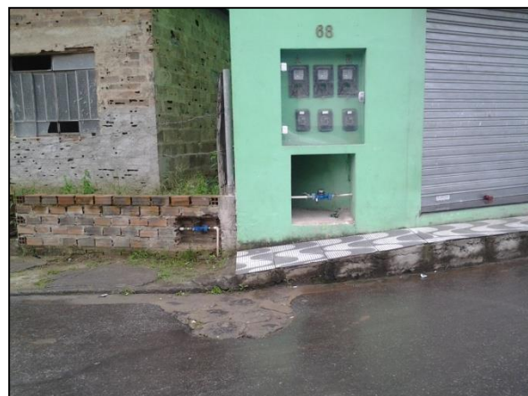
Figura 57 – Ligação com hidrômetro
