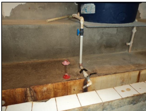
Figura 32 – Rede de distribuição da ETA Varjão
