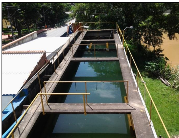
Figura 18 – Vista da ETA Pirai
