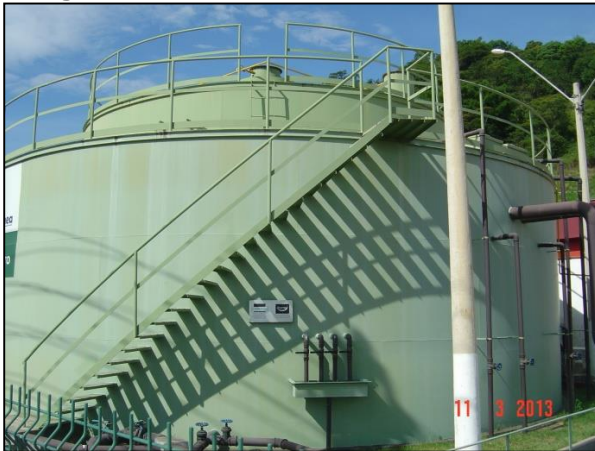
Figura 65 – Vista da ETE sub-bacia D
