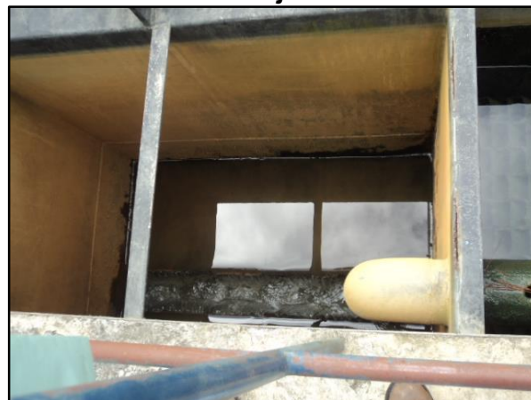
Figura 31 – Processo de filtração ETA Varjão
