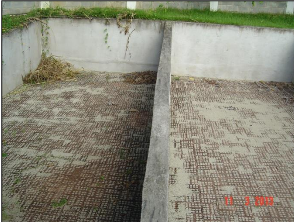
Figura 63 – Leito de secagem – ETE sub-bacia A.
