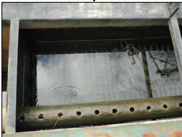
Figura 30 – Tanque de decantação ETA Varjão
