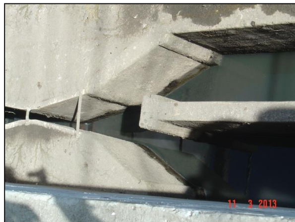
Figura 68 – Sistema primário da ETE sub-bacia D
