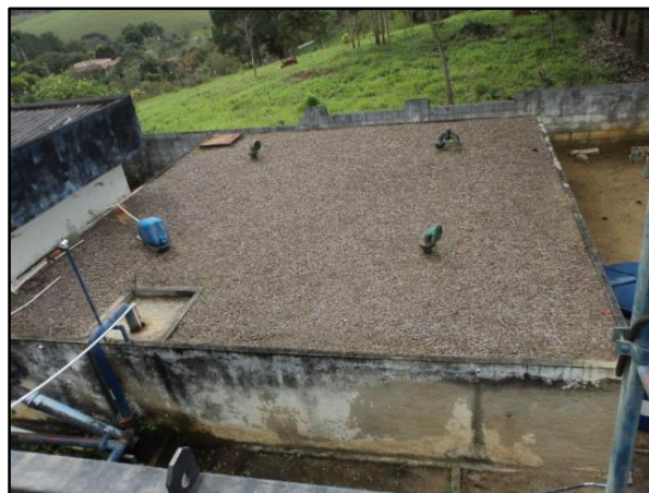
Figura 53 – Reservatório anexo a ETA Varjão
