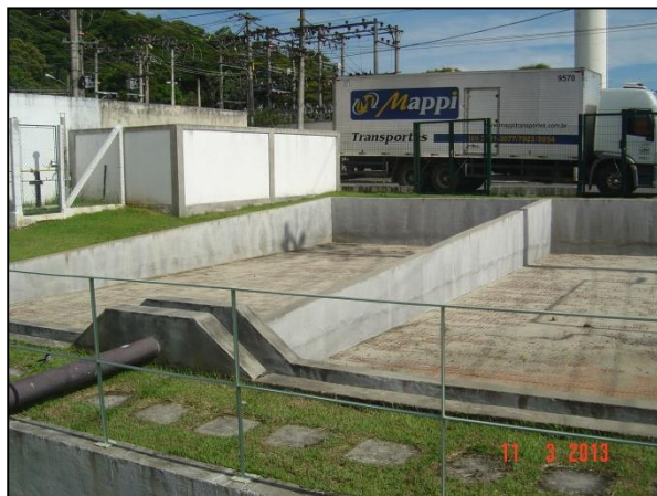
Figura 67 – Leito de secagem – ETE sub-bacia D
