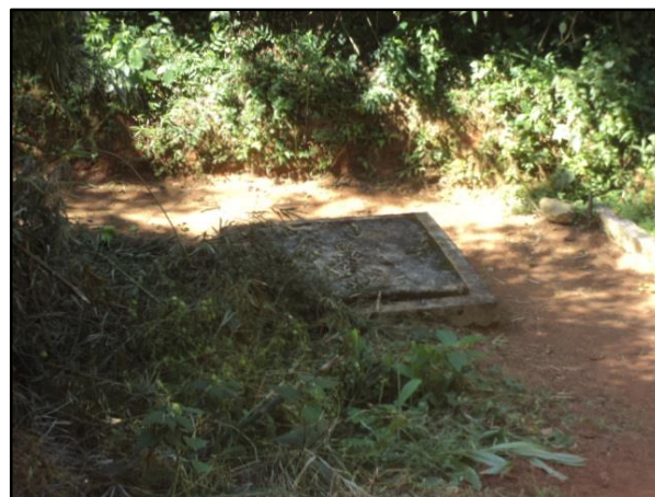
Figura 18 – Caixa de captação da nascente Carrijo
