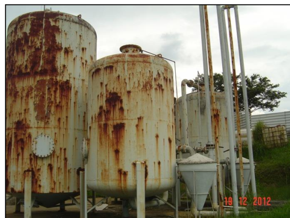
Figura 11 – Vista dos filtros da ETA Bondarowsky
