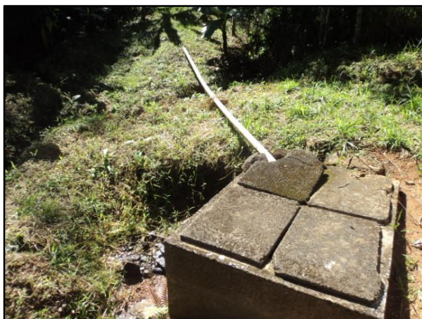
Figura 14 – Caixa de passagem
