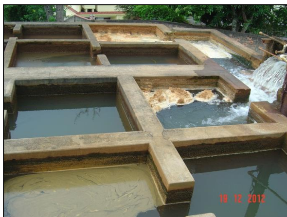
Figura 10 – Unidade de floculação da ETA Bondarowsky
