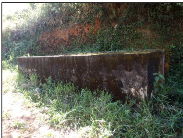
Figura 17 – Caixa de captação da nascente do sítio Chiqueirão
