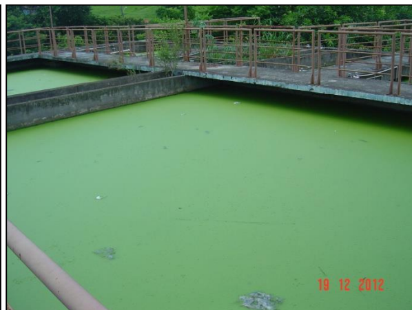
Figura 22 – Vista do sistema de tratamento
