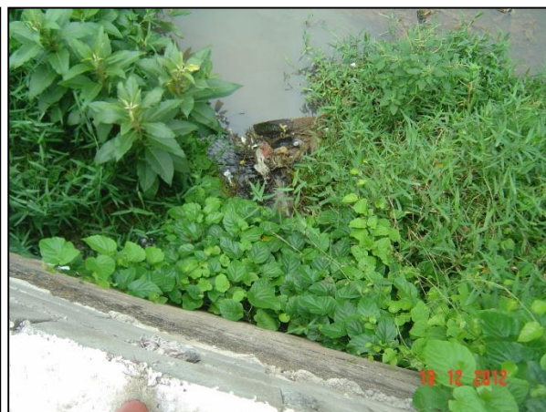
Figura 24 – Lançamento de esgoto no Ribeirão dos Quatis
