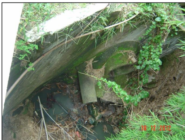
Figura 23 – Lançamento de esgoto no Ribeirão dos Quatis
