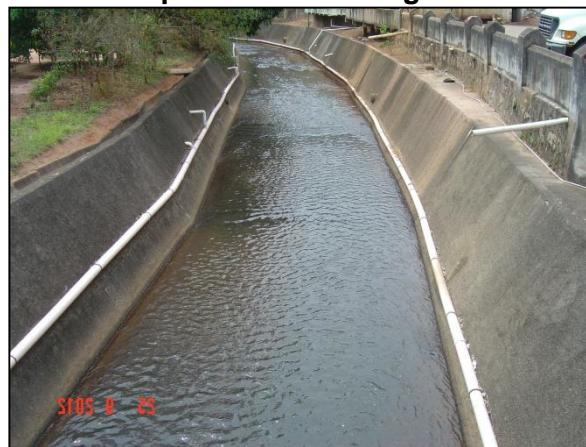
Figura 47 – Lançamento das águas pluviais em córrego
