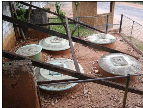
Figura 43 – Fossas filtros intermediárias no distrito de Manuel Duarte – vista 2
