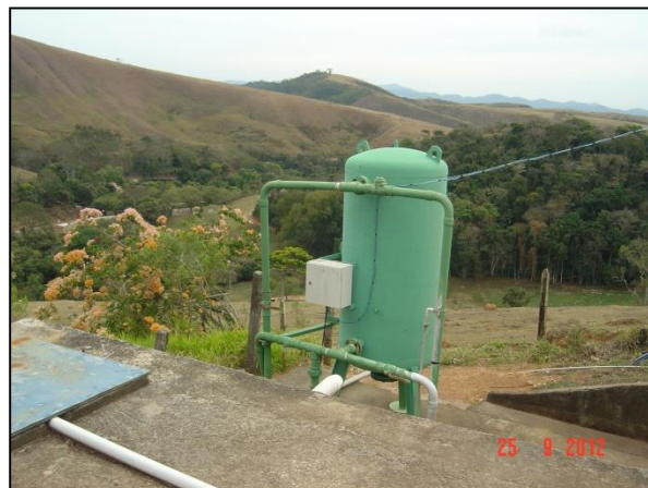
Figura 16 – Sistema de cloração R01
