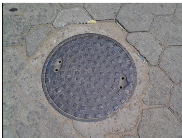
Figura 32 – Poço de visita
