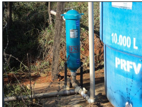
Figura 14 – Unidade de filtração e reservação - Abarracamento 2
