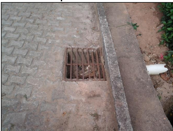
Figura 50 – Boca de lobo obstruída por pedras e terra
