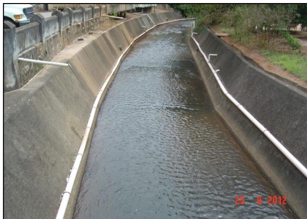
Figura 33 – Canalização predial dentro do curso do rio
