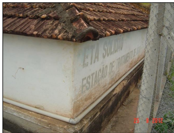
Figura 10 – Vista da ETA Solidão 2
