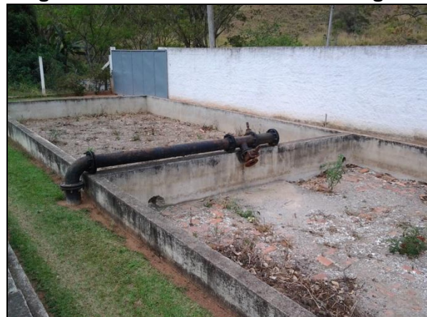
Figura 37 – Vista dos leitos de secagem
