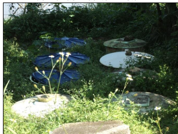
Figura 45 – Fossa séptica final no distrito de Manuel Duarte – vista 2
