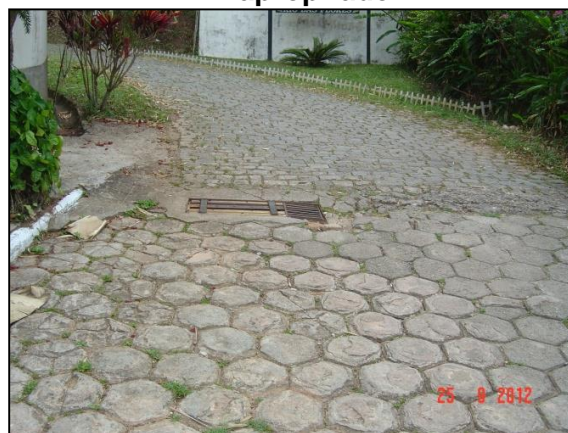
Figura 53 – Boca de lobo em local inapropriado
