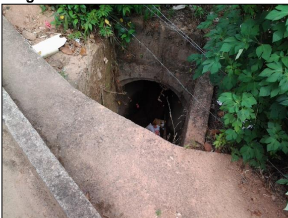
Figura 48 – Amarrete tubular obstruído
