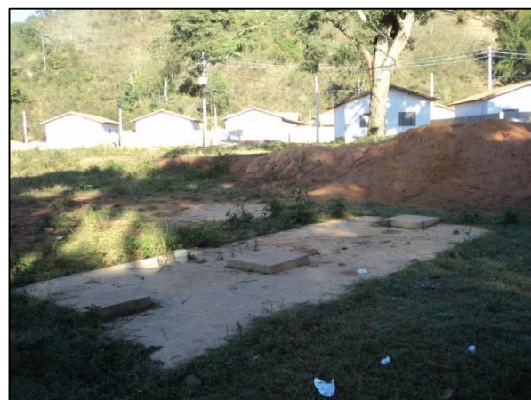
Figura 41 – Fossa séptica Abarracamento 2 - vista 2
