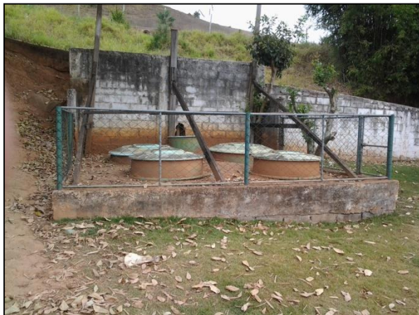
Figura 42 – Fossas filtros intermediárias no distrito de Manuel Duarte – vista 1
