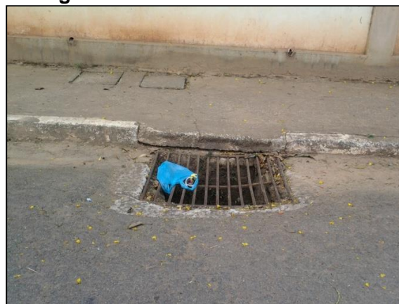
Figura 49 – Boca de lobo obstruída
