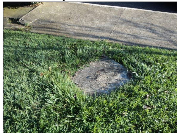
Figura 39 – Fossa filtro no bairro Gov. Anthony Garotinho – vista 2
