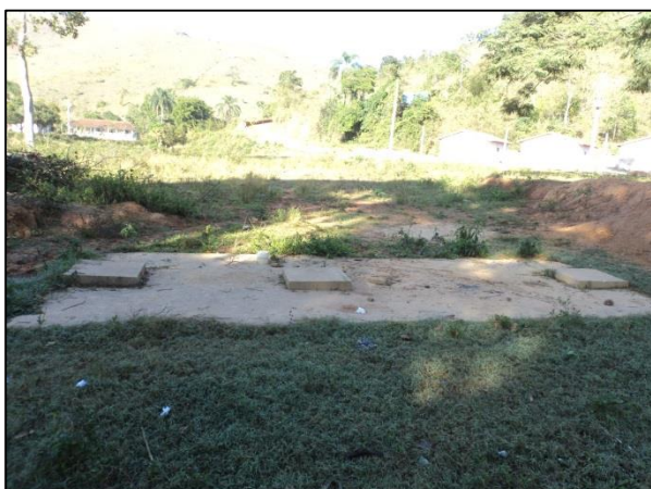
Figura 40 – Fossa séptica Abarracamento 2 -vista 1
