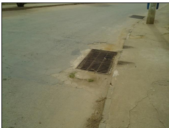
Figura 52 – Vista de boca de lobo
