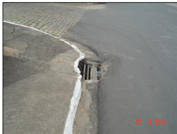
Figura 51 – Boca de lobo danificada
