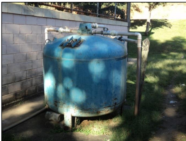
Figura 13 – Unidade de filtração - Abarracamento 1
